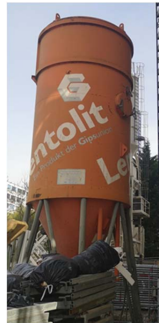
Le silo pour le plâtre est en place, le travail a commencé de suite.
